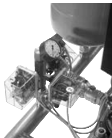
Рис. 21 Реле давления, установленные на коллекторе
